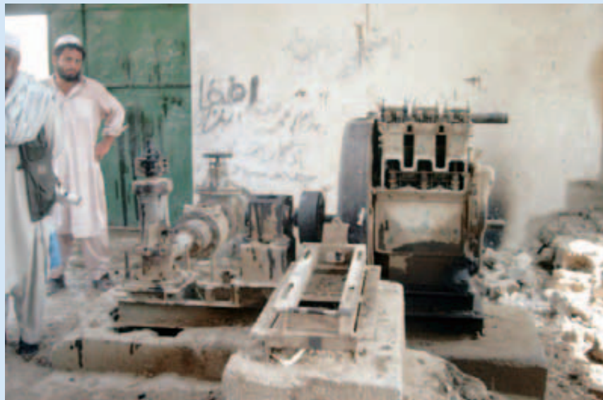
Abb. 3 Der Zustand der technischen Infrastruktur in Afghanistan ist desolat, wie nicht nur die hier abgebildete Pumpstation in Mehterlam verdeutlicht.
