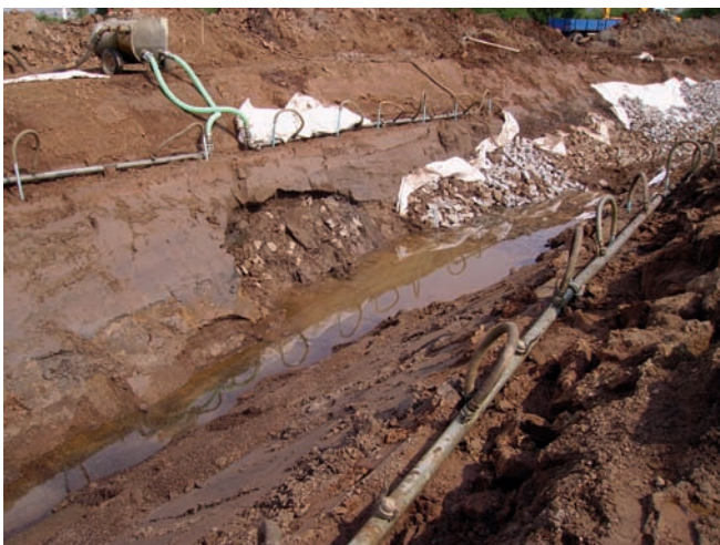
Abb. 6: Spüllanzen zur Grundwasserhaltung
