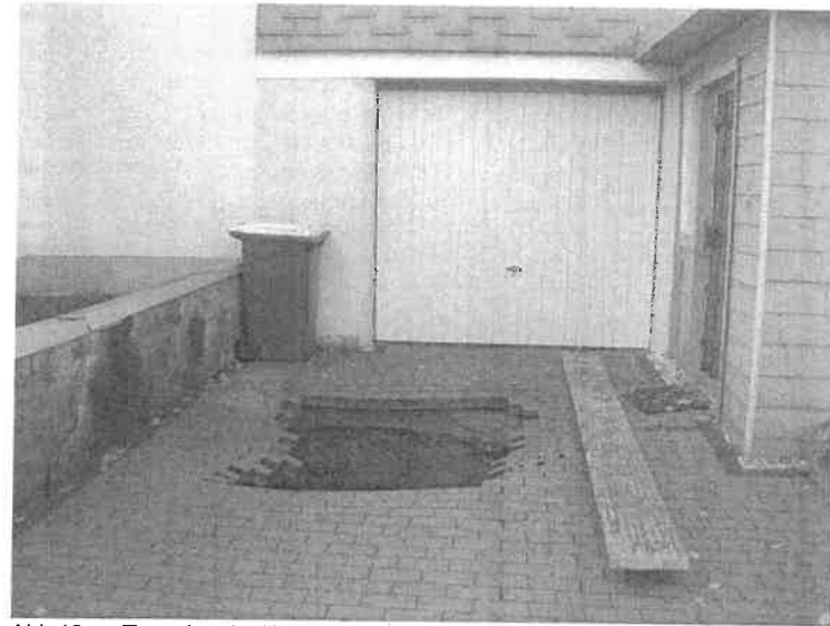
Abb.10 : Tagesbruch „Alter Schacht“
