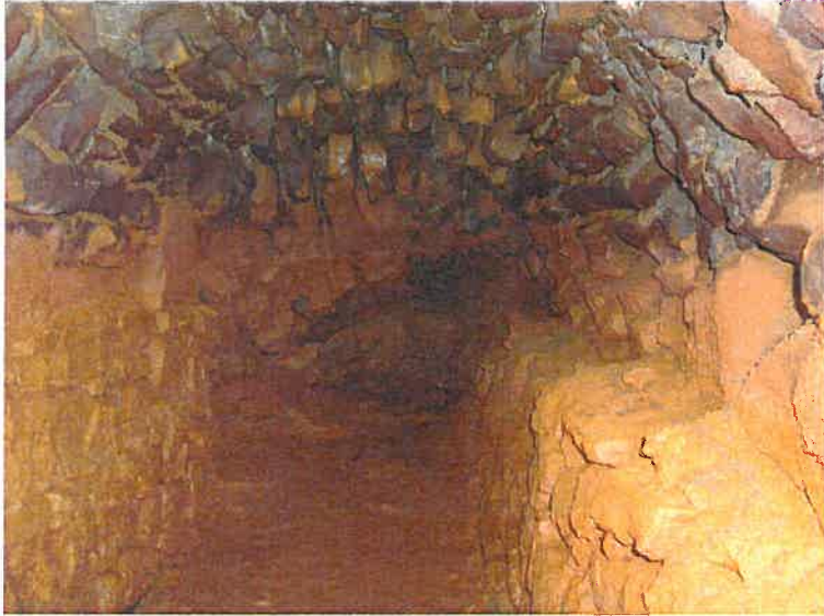
Abb.7 : Ansicht des Verbruchbereiches in Richtung SW (in Fließrichtung)
