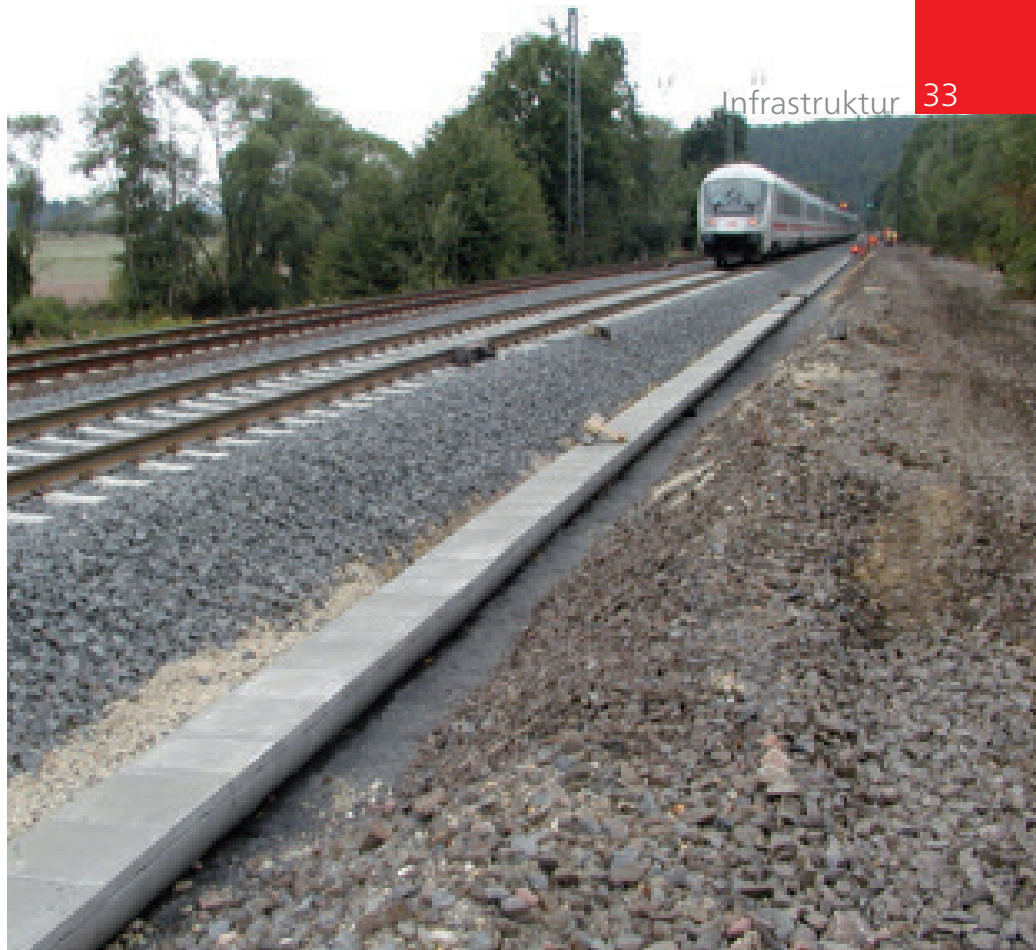
Ein sanierter Gleisabschnitt, bei dem der Randwegbereich mit einem Drän-Versickerungssystem neu gestaltet wurde.
